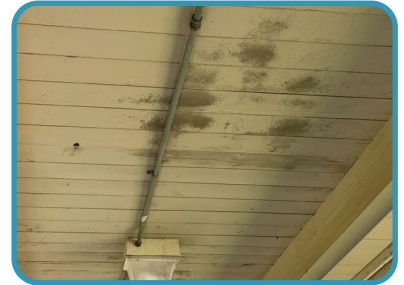
Tejado con filtraciones en la Escuela Secundaria de Culver City
